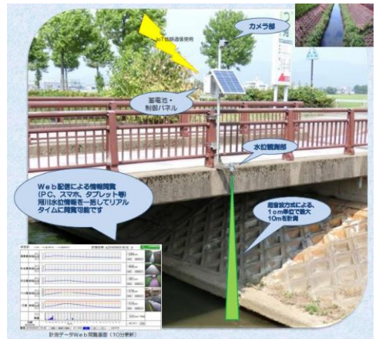
図 10 河川水位計システム
